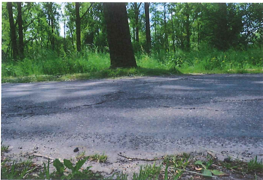
foto 2 Schade aan verharding rijbaan. Oorzaak wortelgroei?
