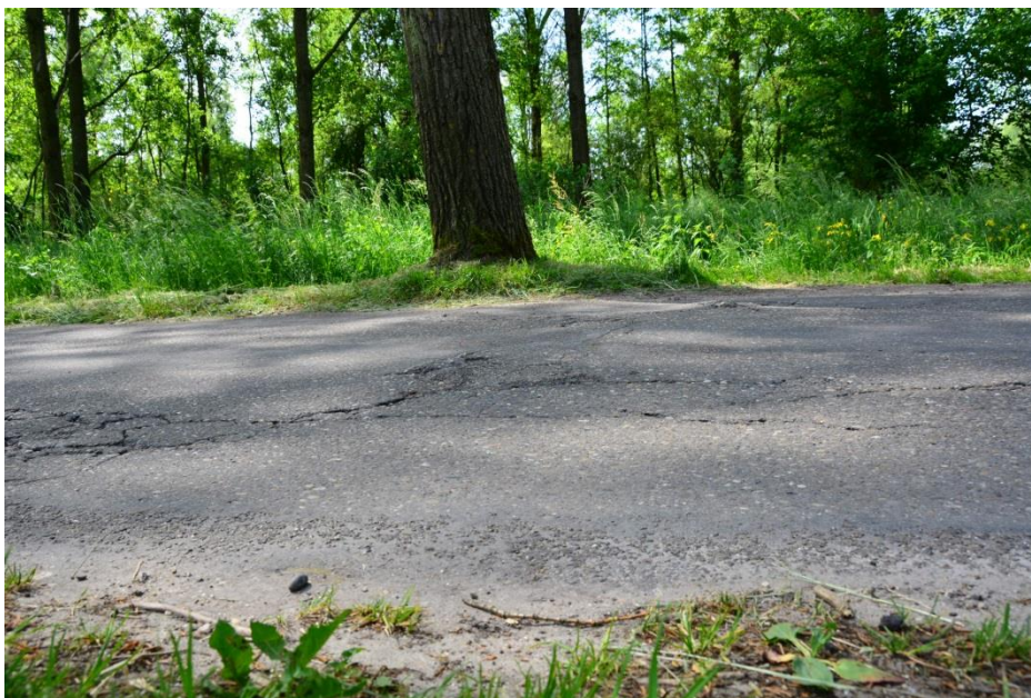
foto 2 Schade aan verharding rijbaan. Oorzaak wortelgroei?
